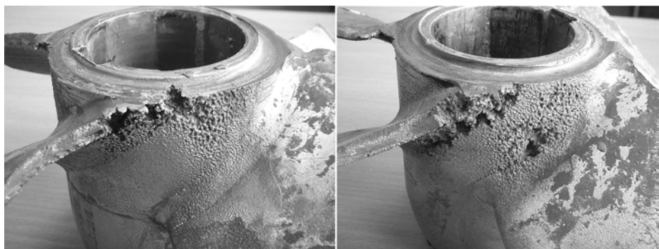
Рис. 6. Участок эрозионного разрушения лопастной системы ПЧ №3 электронасоса НСО-01
