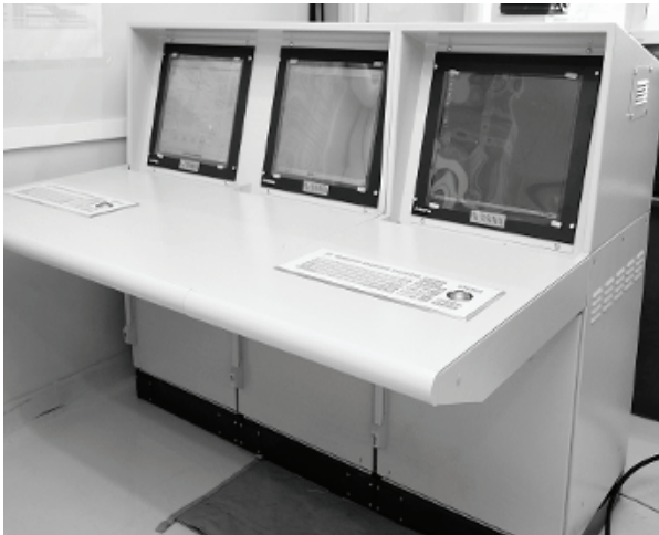
Модернизация системы радиационного контроля – автоматизированное рабочее место сменного инженера
