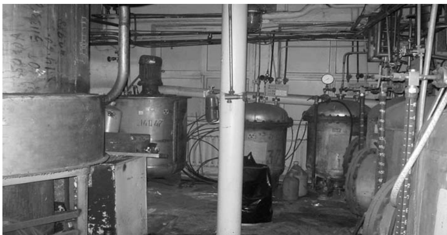
Рис. 1. Оборудование радиохимического стенда
